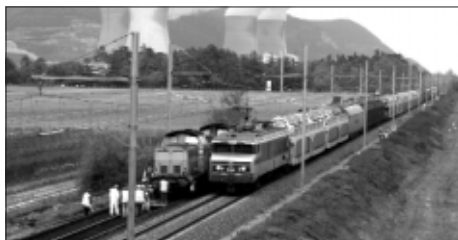
Du débit sur les infrastructures Train de fret doublant un chantier de modernisation
